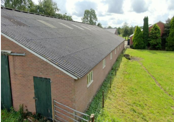
Figuur 16: Asbestverdachte golfplaten
