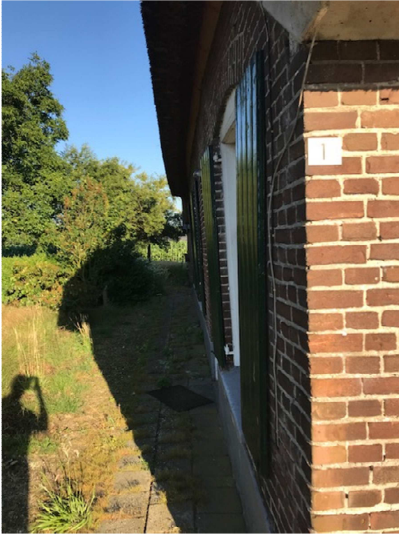
Foto 2: Gevel welke naar voren valt
