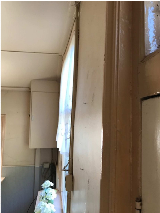
Foto 6: Voorgevel valt naar buiten, niet veilig
