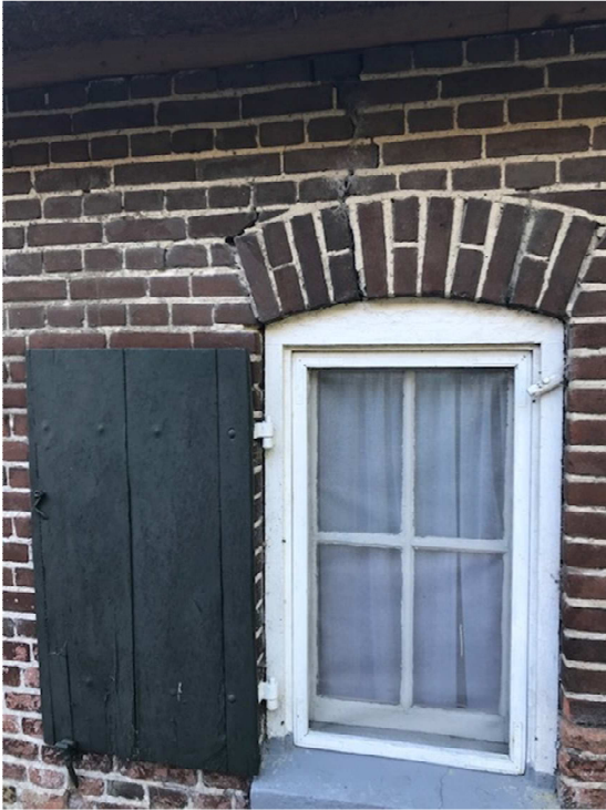
Foto 5: verpoeterd metselwerk valt uit elkaar
