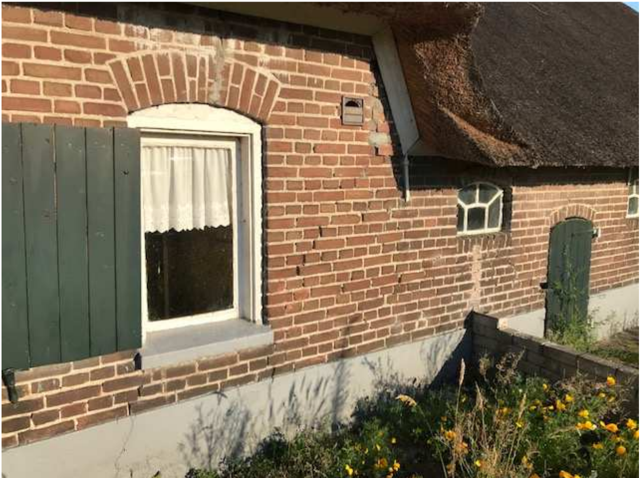
Foto 4: slecht metselwerk vol met scheuren tevens in betonrand
