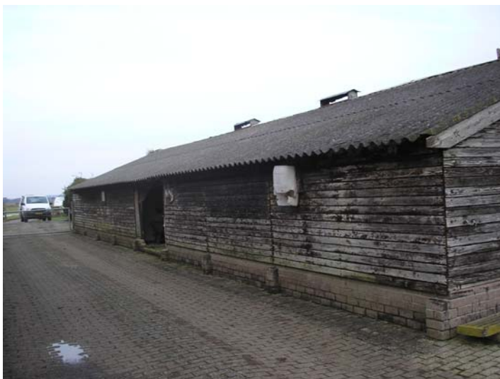
Foto 2: Asbestverdacht plaatmateriaal op schuur
