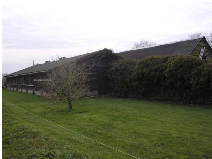
Foto 3: Asbestverdacht plaatmateriaal op schuur
