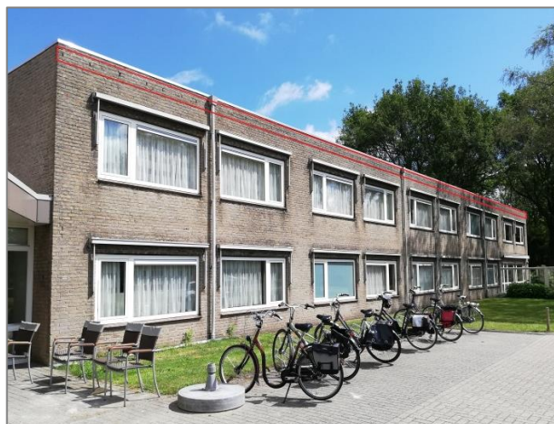
Afbeelding 5.1 | Stootvoegen langs bovenrand van gevel
