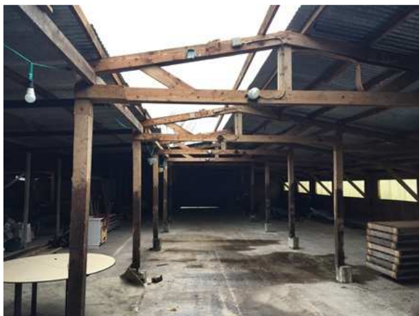
Delen van het dak zijn weg; dit biedt vogels de kans om in het gebouw te nestelen.
