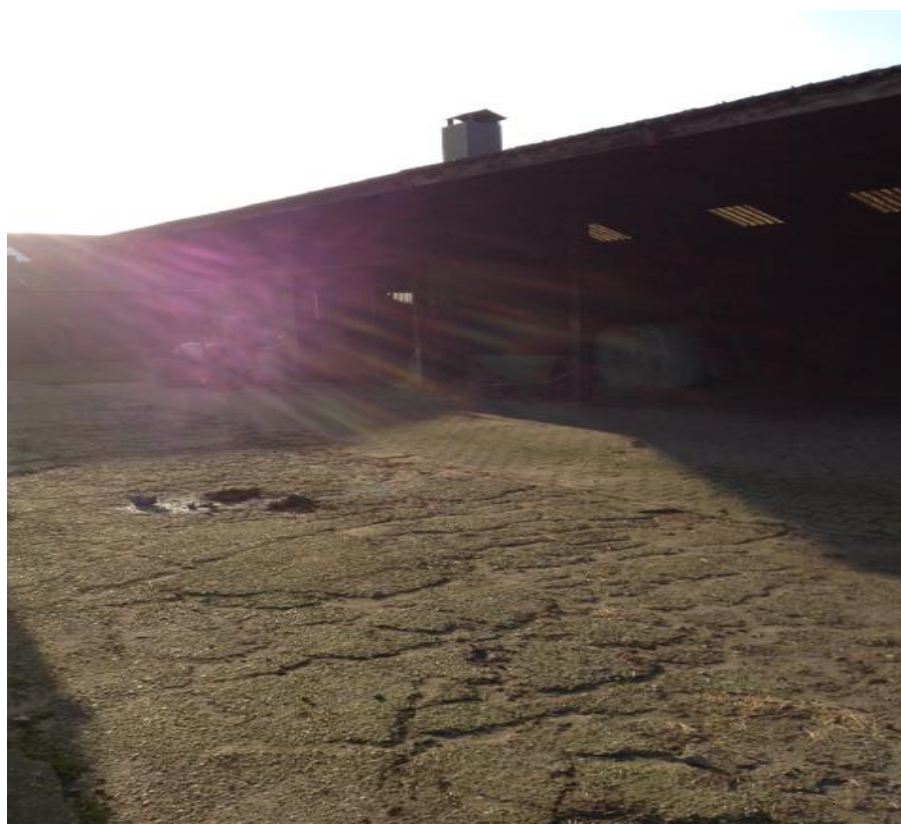
Foto 6: kapschuur met asbesthoudend dak zonder dakgoot
