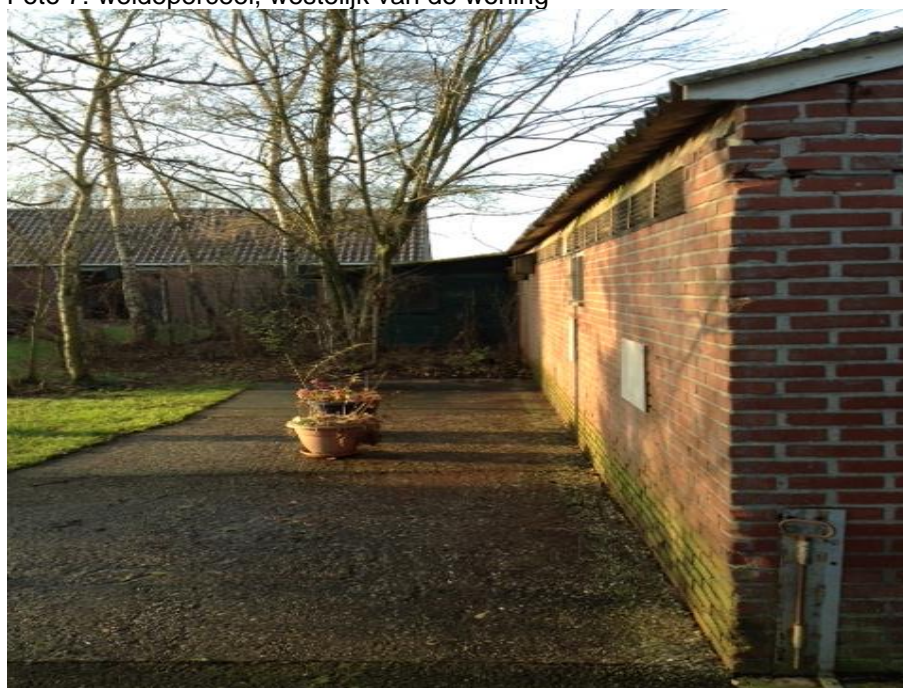
Foto 8: zuidelijke stal met asbesthoudend dak zonder dakgoot
