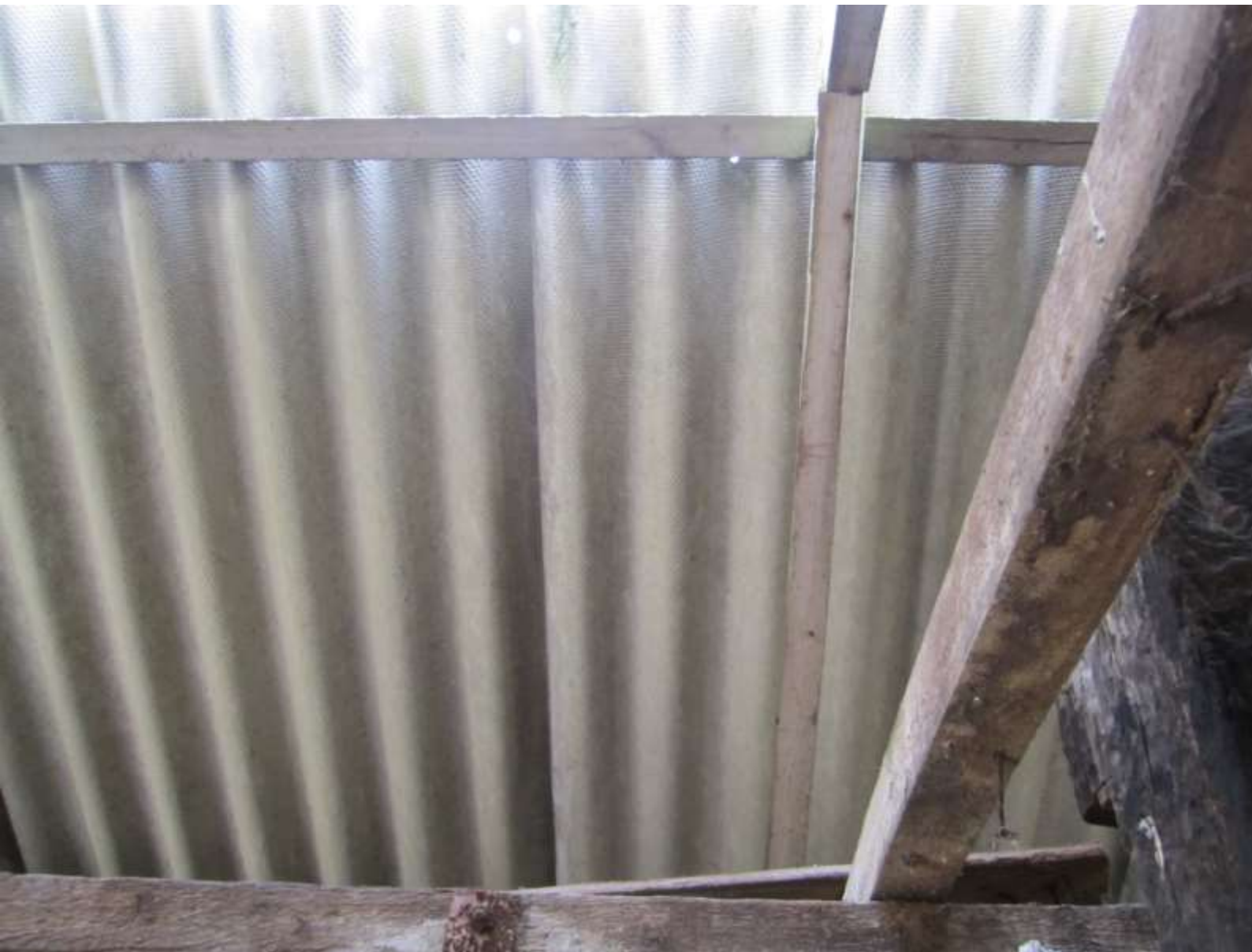
Foto 6. Golfplaten dak van een van de schuren.
