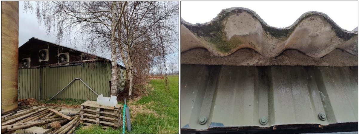
Foto links: opgeslagen materialen rondom de stallen. Foto rechts: faunaweringsvoorziening onder de golfplaten.
