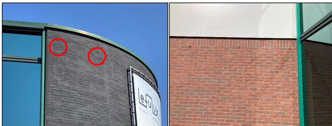
Figuur 6.6 (links): Bovenin de gevel van de zuidoostzijde van het gebouw bevinden zich stootvoegen (aangegeven met de rode cirkel); Figuur 6.7 (rechts): Ook in de andere gemetselde muren van het gebouw zijn stootvoegen aanwezig.
