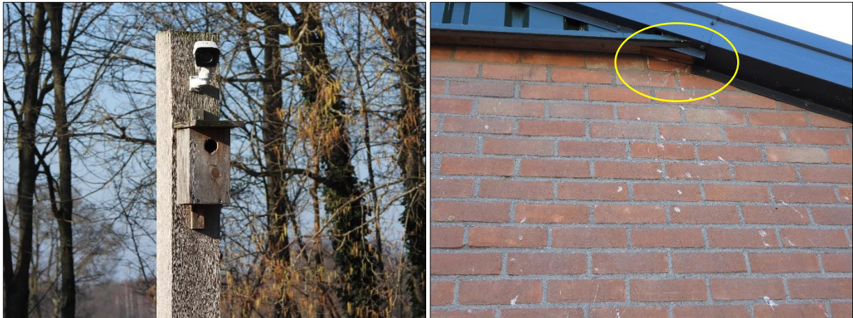
Foto links: mezen en ringmussen kunnen nestelen in het nestkastje naast de carport, foto rechts; oud spreeuwennest aangetroffen aan de te slopen schuur.
