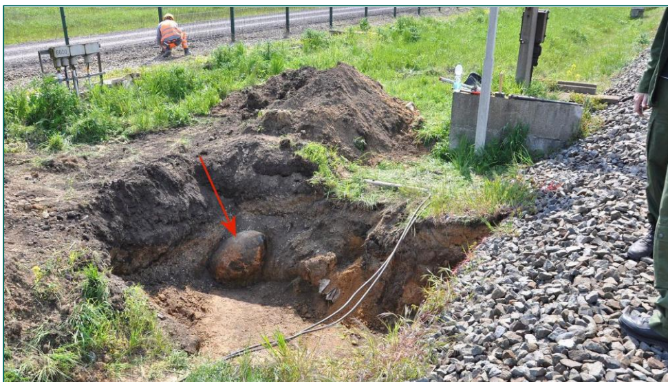
Figuur 16: Ligging blindganger op nauwelijks 75 cm diepte langs een spoorbaan (Bron: REASeuro-database).
