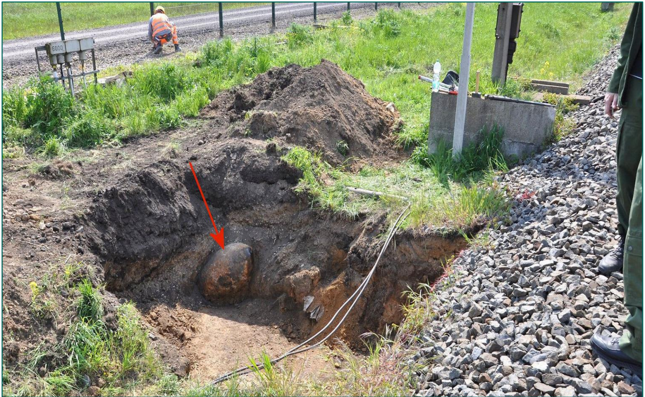
Figuur 25: Ligging blindganger op nauwelijks 75 cm diepte langs een spoorbaan (Bron: REASeuro-database).
