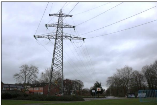
Figuur 4.13. Mast 1 (oostzijde TenneT station)
