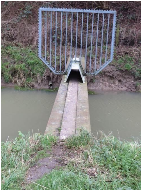
Foto 14: voorbeeld van stalen loopplank over sloot. Rooster alleen nodig indien menselijk gebruik niet wenselijk is.
